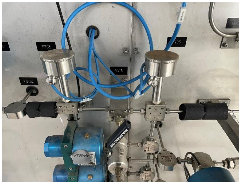
Abbildung 7: Nachgerüstete Messstellen 6-7 an der Schalttafel
