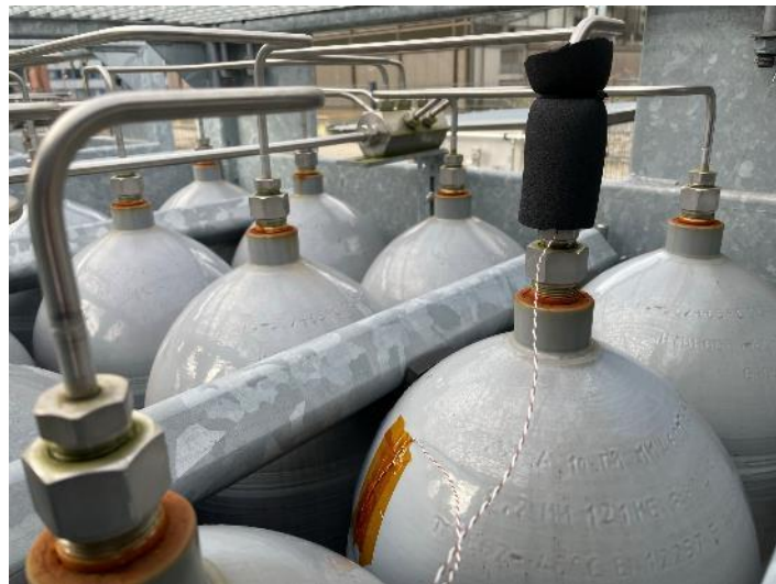
Abbildung 9: Nachgerüstete Messstellen 14-17 am Mitteldruckspeicher (Segmente 4-5)
