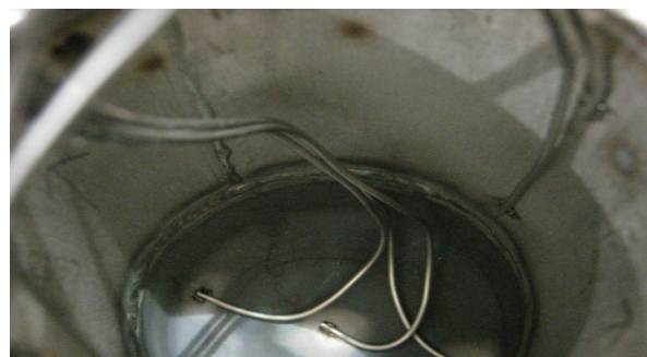
Abbildung 5: Innenansicht der Brennkammer im Reformerreaktor
