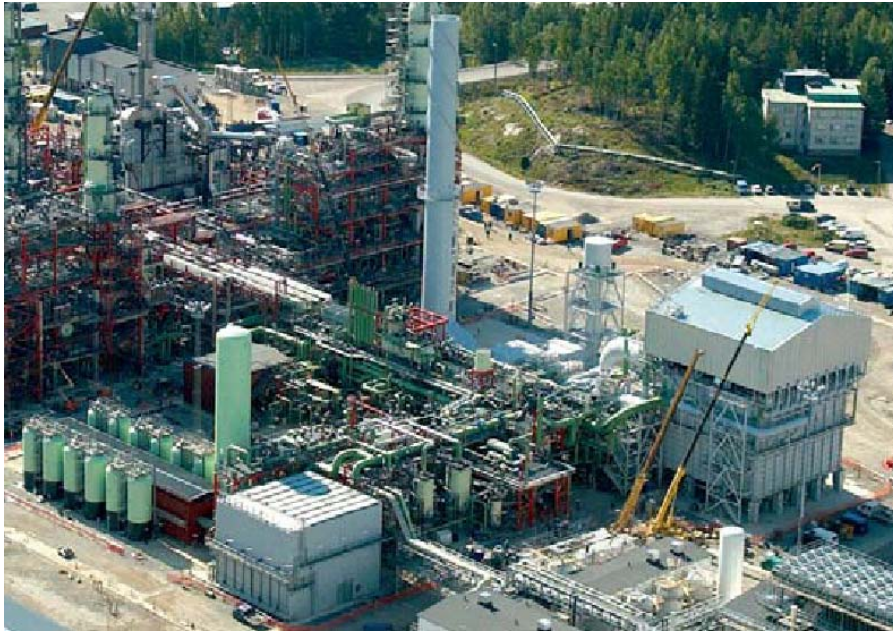
Europas größter einzügiger Dampfreformer der Raffinerie der Firma Neste Oil Oy in Porvoo, Finnland, mit einer Kapazität von 153.500 Nm 3 /h (Quelle: Uhde GmbH)
